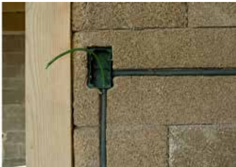
Schlitz im Biomattone® für Elektroinstallation
