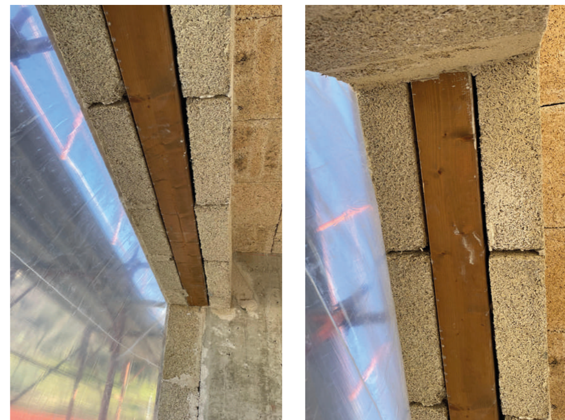
Posa in opera di architrave in legno essiccato su parete in Biomattone® con ponte termico risolto
