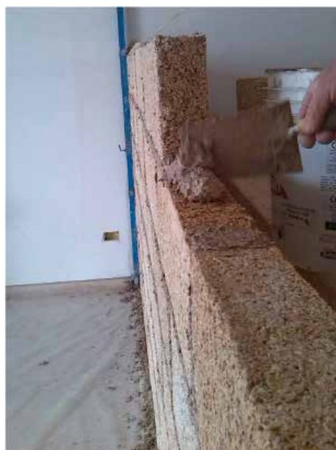
Pose du Blocco Ambiente® avec pose d'une couche de MSC® Malta Strutturale di Calce (Mortier structural à la chaux) (1)
