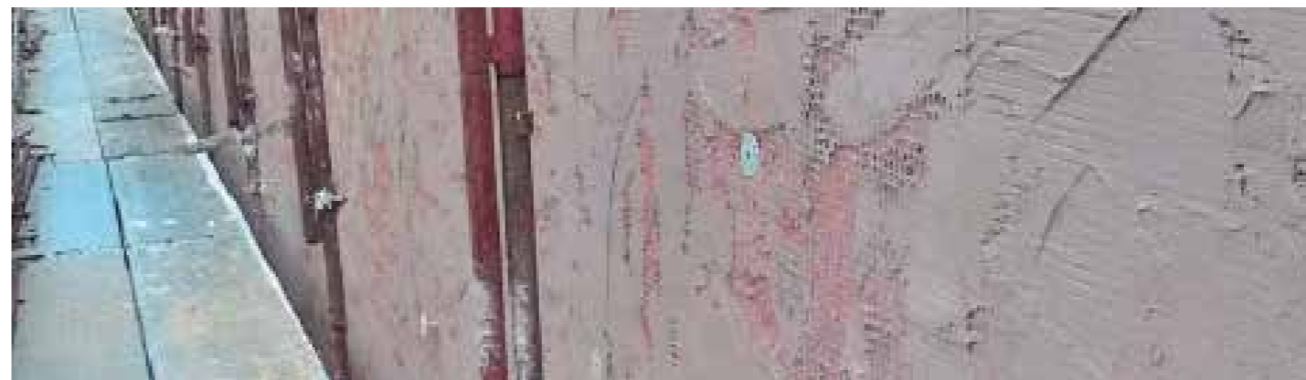
Colocación red de aislamiento con aplicación primera capa de Estabilizante Natural Transpirable Plus.
