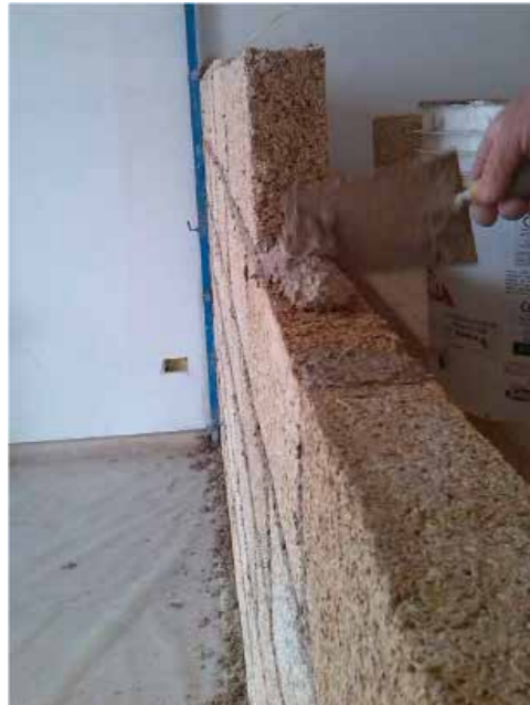
Posa in opera Blocco Ambiente® con stesura strato di allettamento in MSC® Malta Strutturale di Calce (1)
