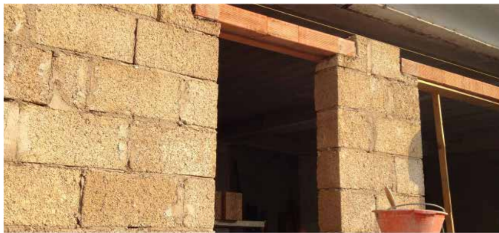
Posa in opera di architrave in latero-cemento su parete in Blocco Ambiente®
