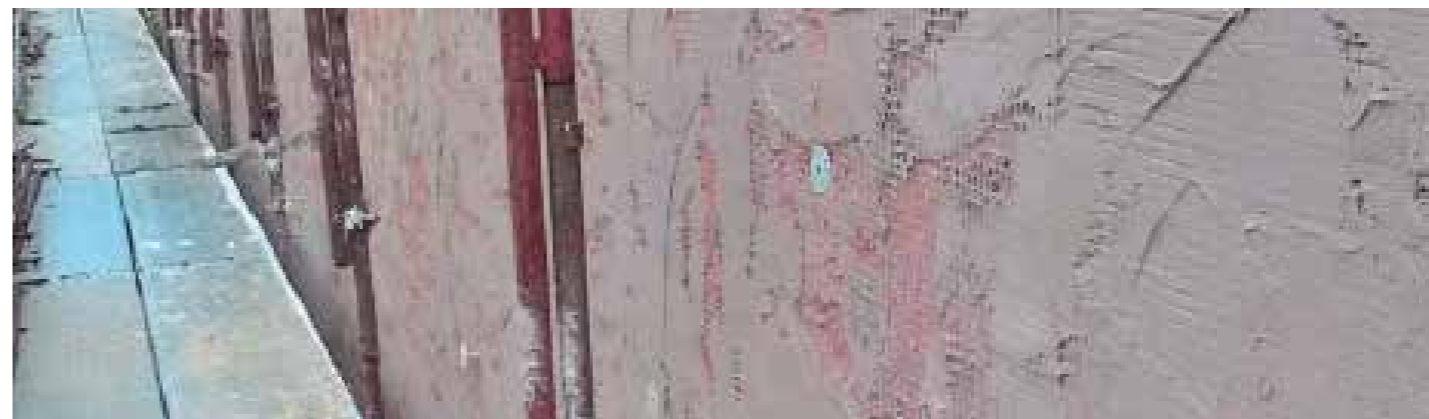
Apposizione rete da cappotto con stesura prima mano di Stabilitura Naturale Traspirante Plus.
