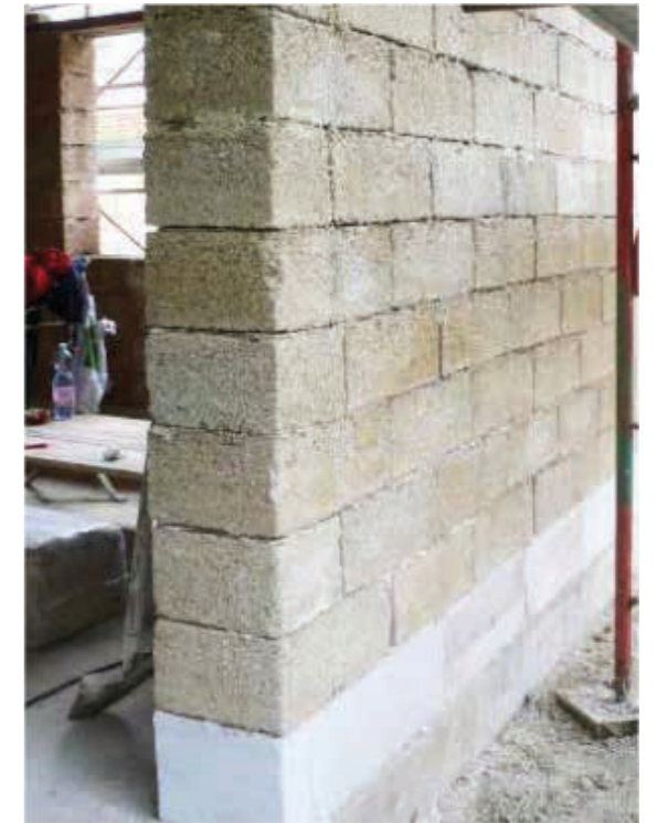
Isolation de la première couche de Blocco Ambiente® avec couche contre terre en verre cellulaire
