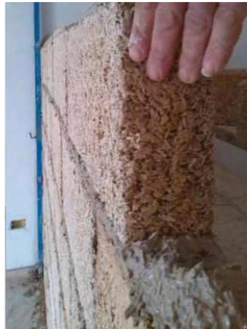
Pose de Blocco Ambiente® avec pose d'une couche de MSC® Malta Strutturale di Calce (Mortier structural à la chaux) (2)
